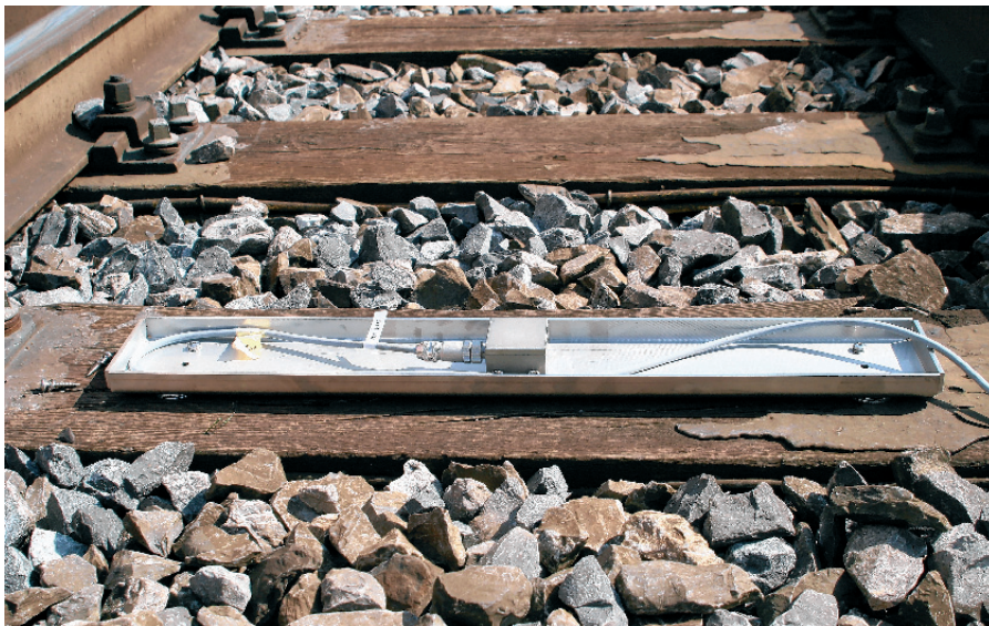
Einer der 16 Punkte, um die Neigung der Geleise in X- und Y-Richtung zu erfassen
